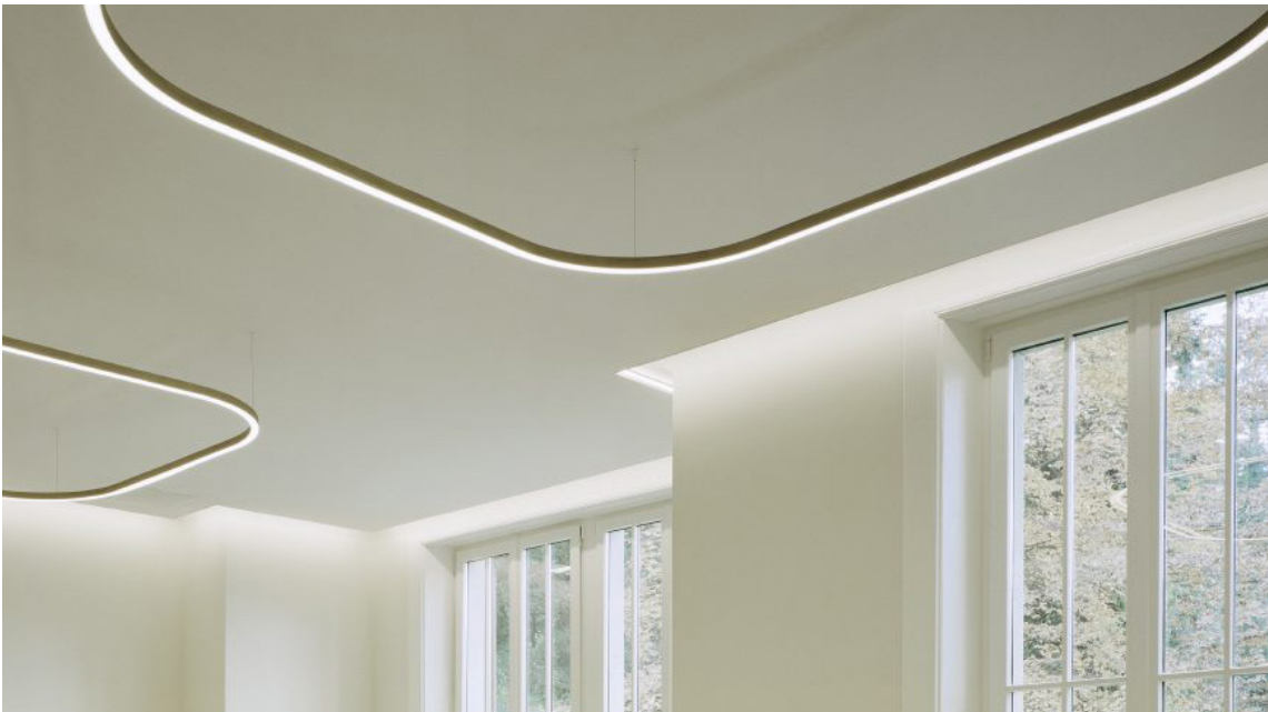
BEISPIEL BASWAPHONDECKE MIT INDIREKTER BELEUCHTUNG
